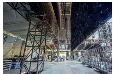
Freie Durchgänge ohne Windverbände zwischen Bühne und dem Storage-Bereich.
